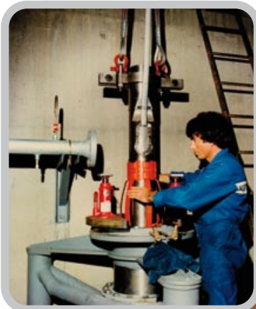
🔗 Développement d'organes de forage dans le puits profond 60m / Drilling part development in our deep wells 60 meter
